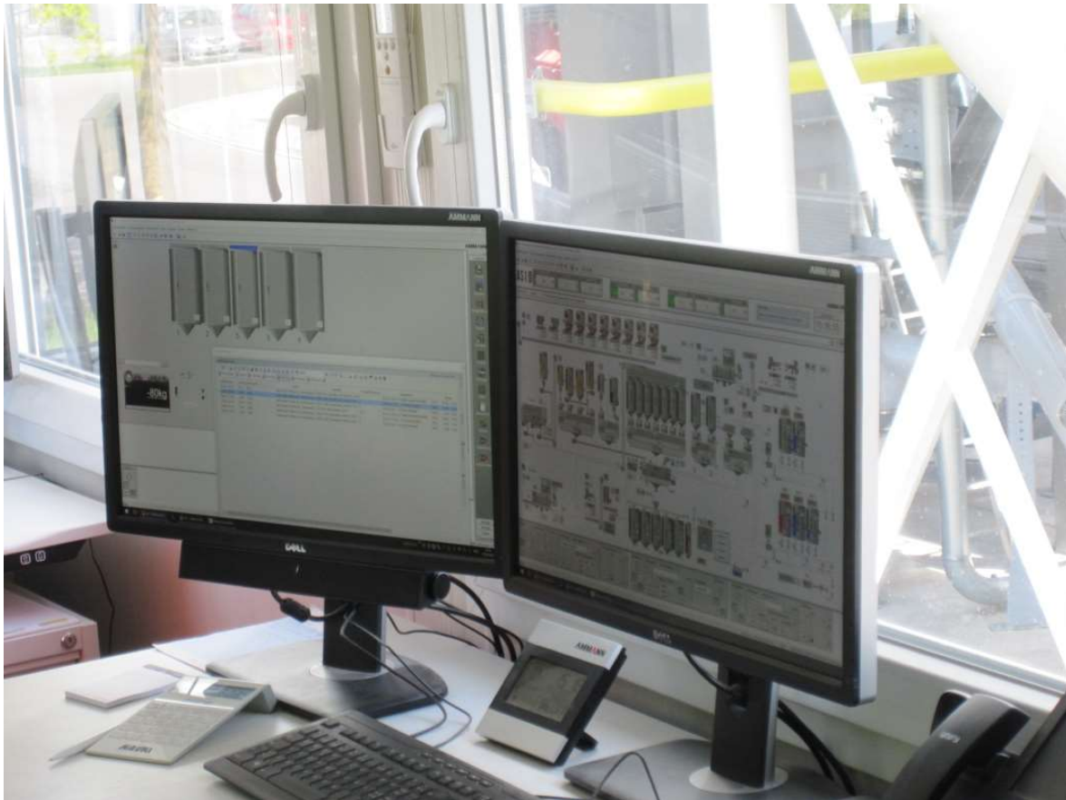
Abbildung 12: Steuerungssoftware im Container des Mischmeisters
